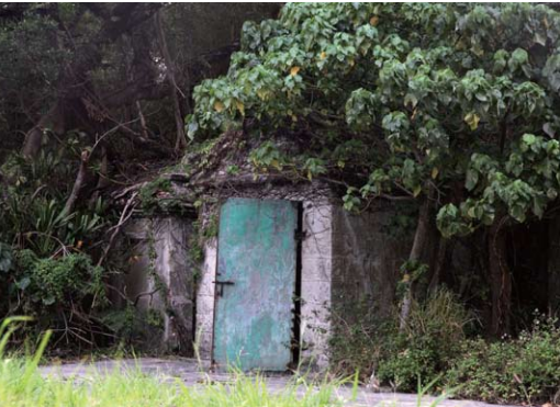
審計署指舊牛奶公司高級職員宿舍缺乏打理，以至破舊失修
